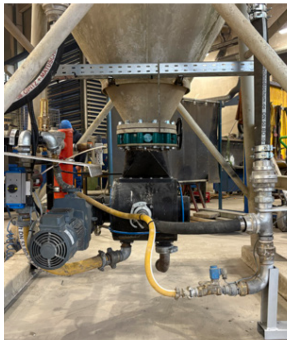
Installierter Rotom8 unter Freifallsilo, Bernegger Werkstatt
